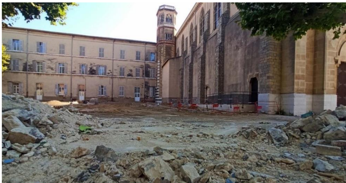
Figure 1 - Vue sur l'institution des Maristes après destruction du mur d'enceinte
