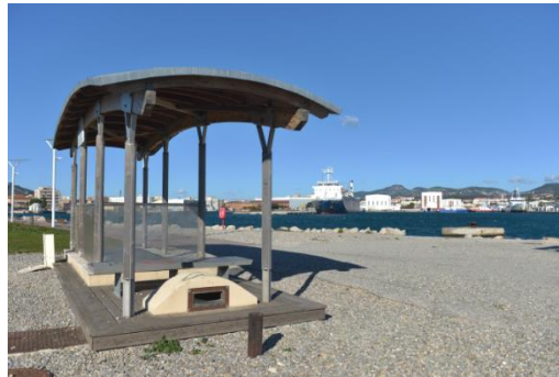
L'installation de thalassothermie vue de l'extérieur à la Seyne-sur-Mer
